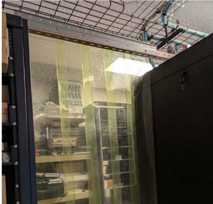
Figure 3.6 : Cloison en plastique entre le dispositif de refroidissement et le reste du centre de données.
