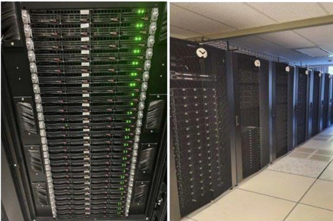
Figure 3.3 : Images d'un centre de données et de postes de travail montés en baie. Chaque lumière verte correspond à un poste de travail. Il y a 27 baies dans la salle des serveurs. Le type et la quantité d'appareils logés dans ces baies varient.
